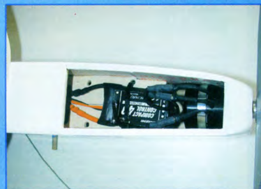
L'ensemble motorisation en place : bien plus facile que d'installer un moteur thermique et son réservoir.
